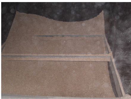
Blick ins Brennstofflager
