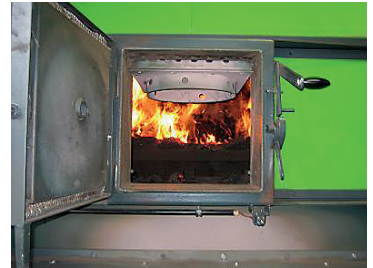
HHS-Kessel im Betrieb (Feuerraum)
