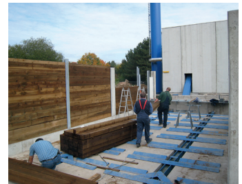
Schubboden im HHS-Lager (Montage)
