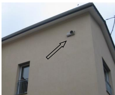
Außen- und Fortluftventil der Lüftungsanlage an der Außenwand
