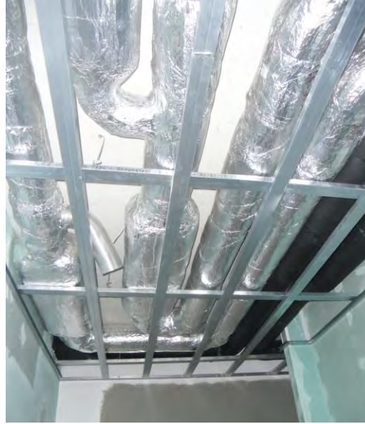
Luftverteilung Decke Badezimmer
