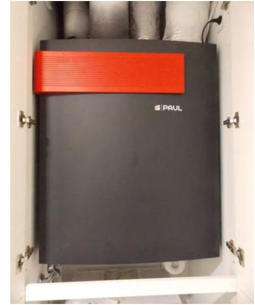
Lüftungsgerät je Wohnung
