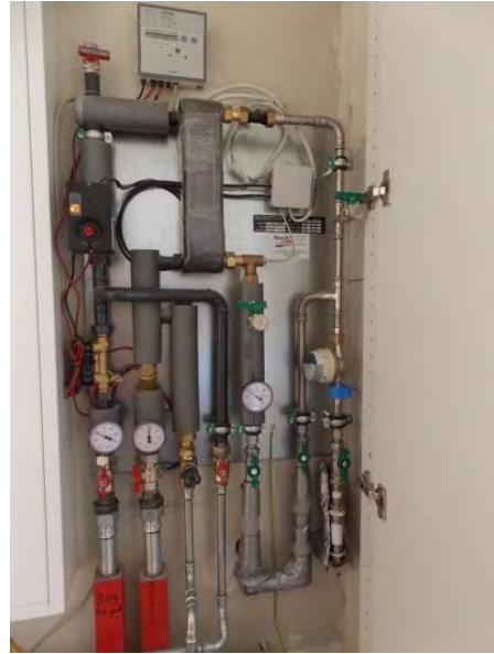
Trinkwasserstation je Wohnung
