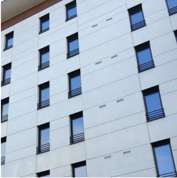
Luftansaugung in Fassade
