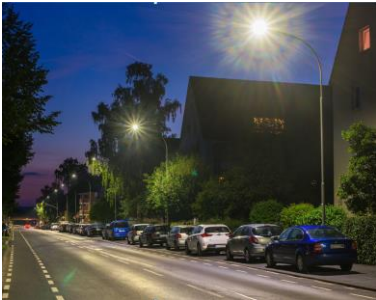
Beleuchtungssituation in der Sudetenlandstraße nach der Modernisierung
